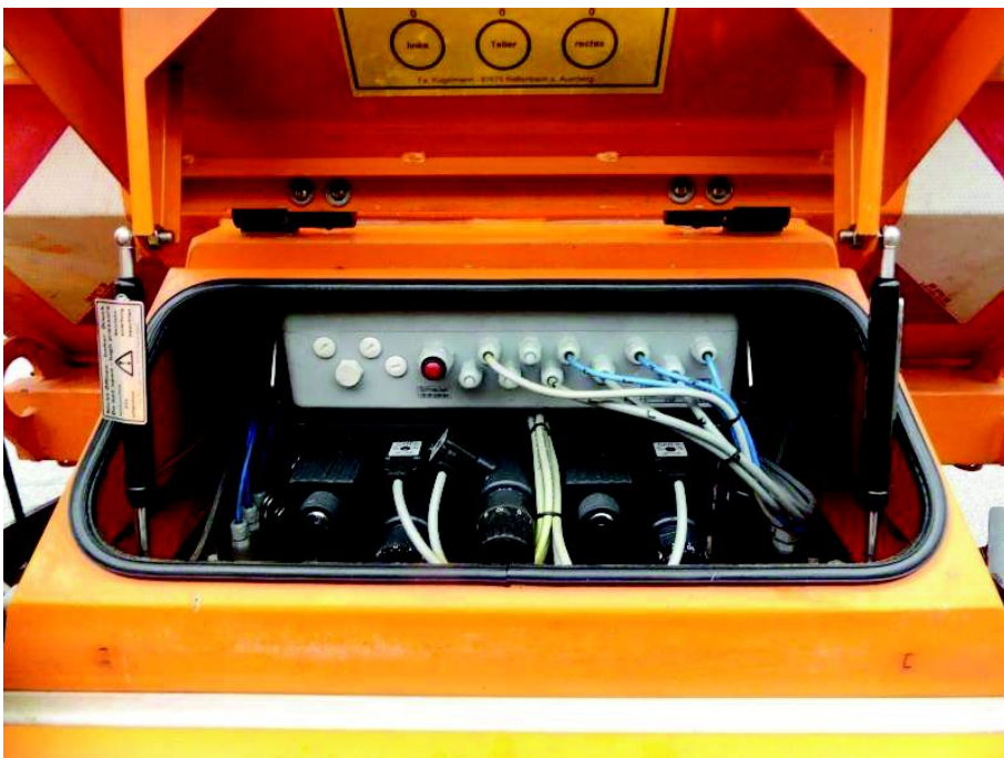
Steuereinheit des Salzstreuers ohne Korrosion oder Schäden
