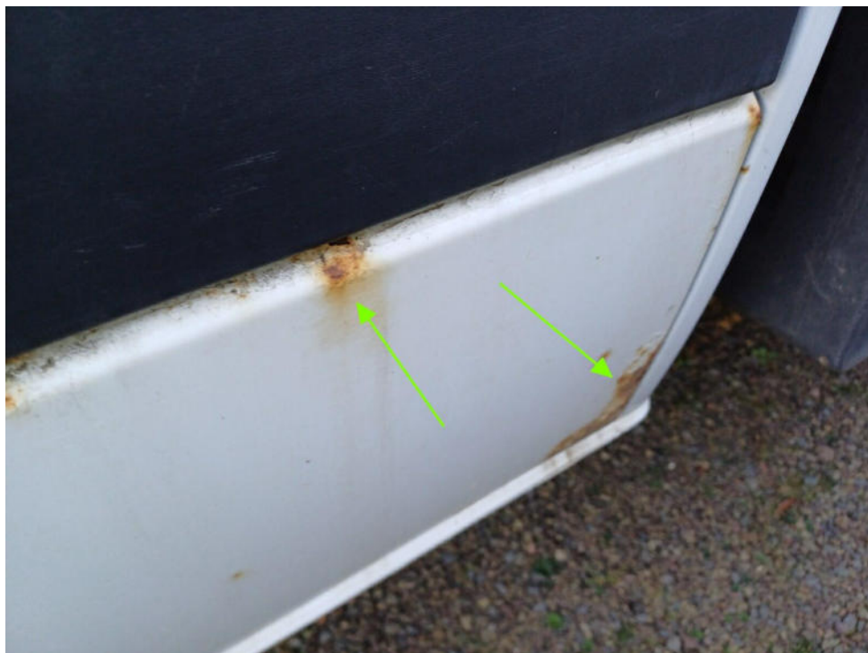
Bild 10 : Tür hinten links stark angerostet
